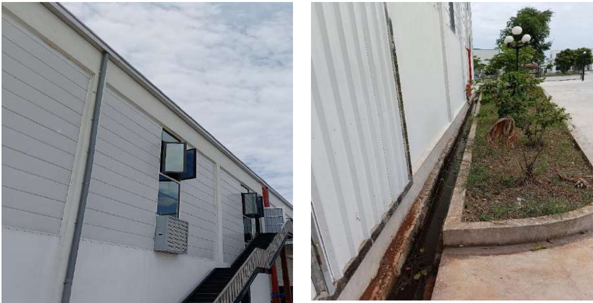
Hình 16. Hệ thống thu gom, thoát nước mưa
